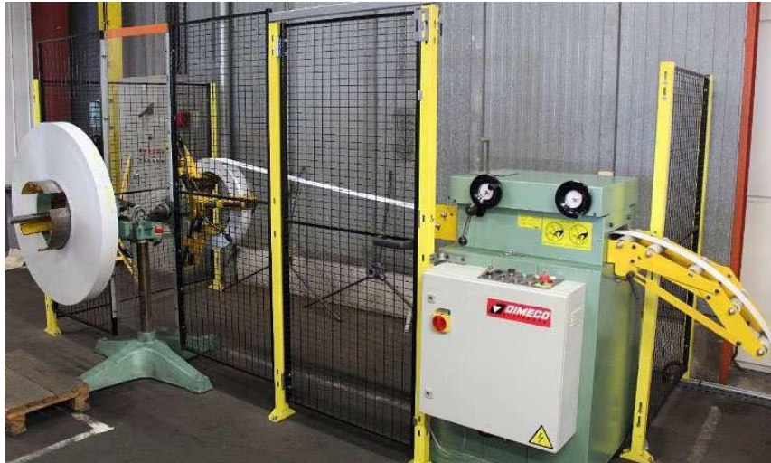
Le redresseur situé en aval du dévidoir
